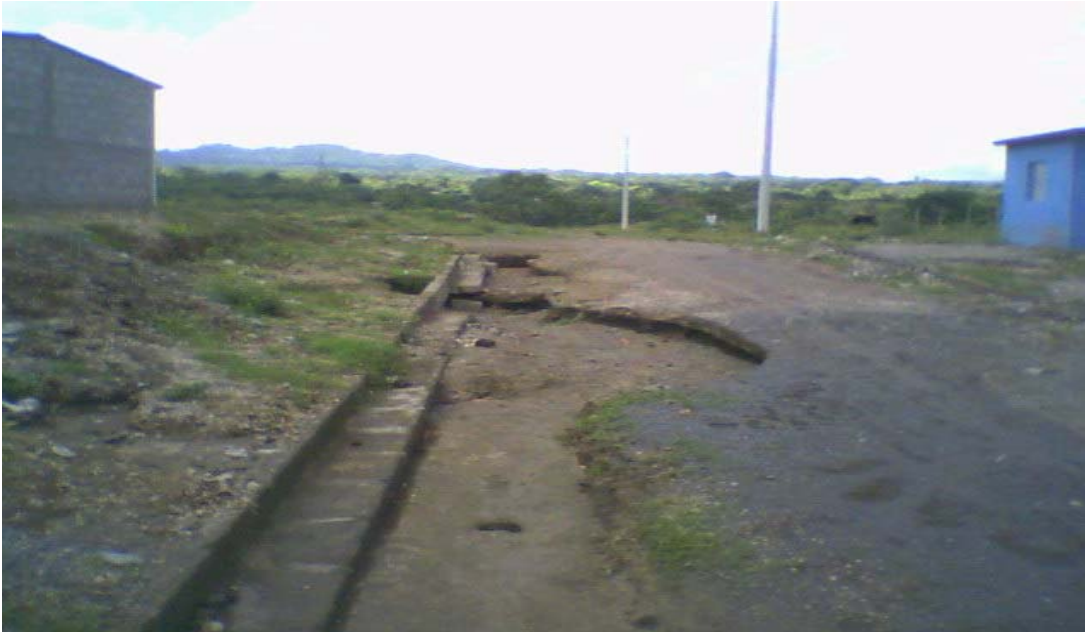
foto 2: erosie van het wegdek in Salto Transatlántico
